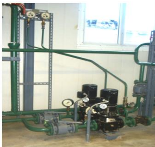
Рисунок 3 – Насос для подпитки
