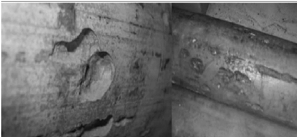
Рисунок 12 – Коррозионное разрушение на корпусах ПЭД и ГД
