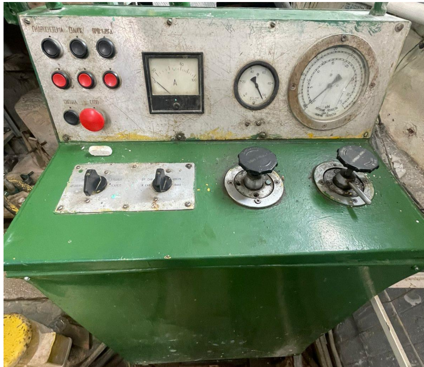
Рисунок 4.4 – Станция управления буровой установкой
