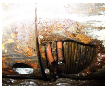
Рисунок 11 – Сквозная коррозия погружного оборудования
