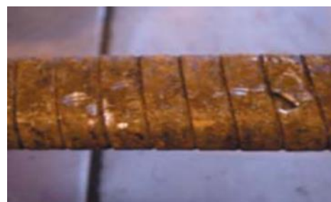
Рисунок 12 – Коррозия брони кабеля
