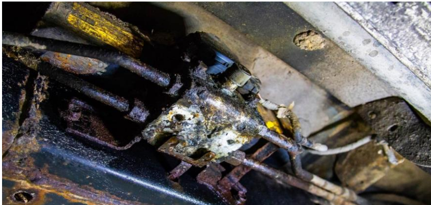
Рис. 1. Коррозия модуля KDSS
