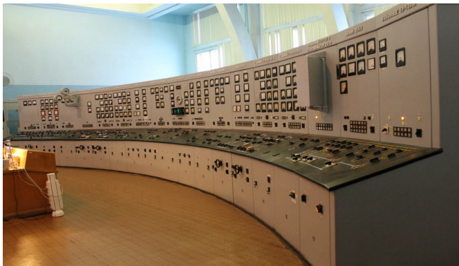
Рис. 4. Щит управления электростанции
