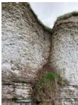
Рис. 1. Заполнение трещины делювиальным материалом
