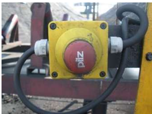
Рис. 1. Кнопка аварийной остановки
