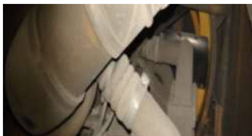
Рис. 4. Ослабленный хомут системы подачи воздуха
