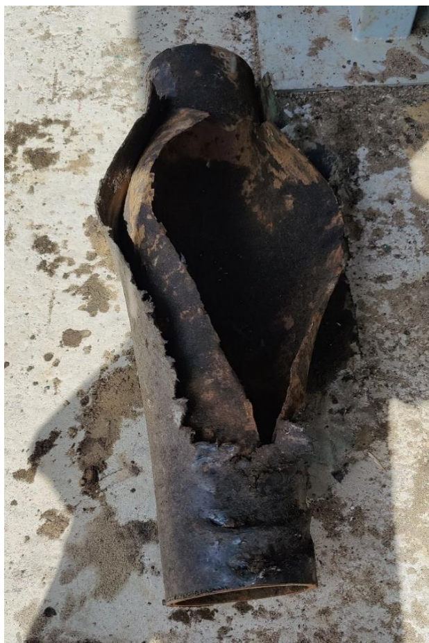
Рис. 3. Разрыв трубопровода по причине наличия канавочного износа
