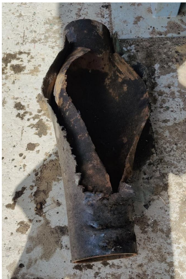
Рис. 3. Разрыв трубопровода по причине наличия канавочного износа
