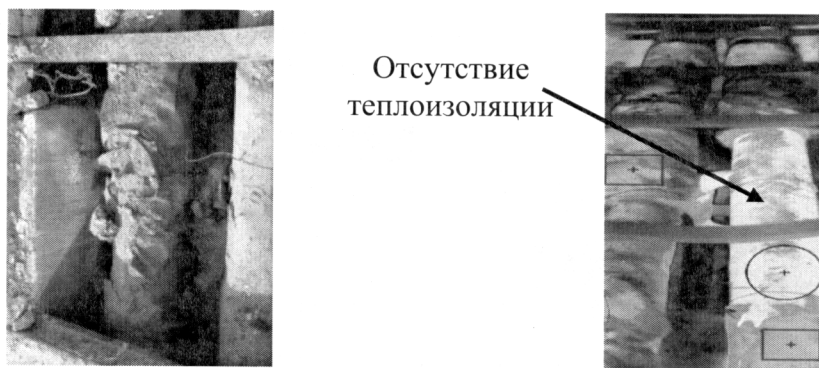
Рис. 4. Оценка тепловых потерь в тепловых коммуникациях г. Томска (слева – фотография шурфа, справа – ИК термограмма)
