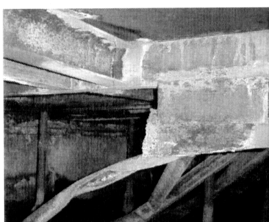
Фото 1. Деформация угловой опоры перекрытия
