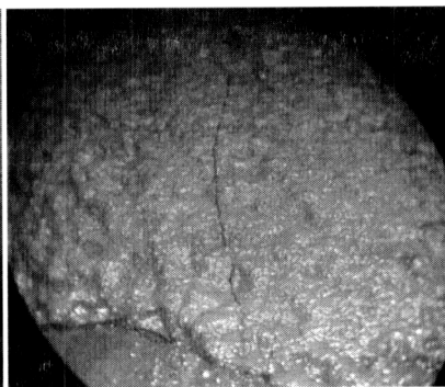
Фото 5. Трещина в торкретном покрытии
