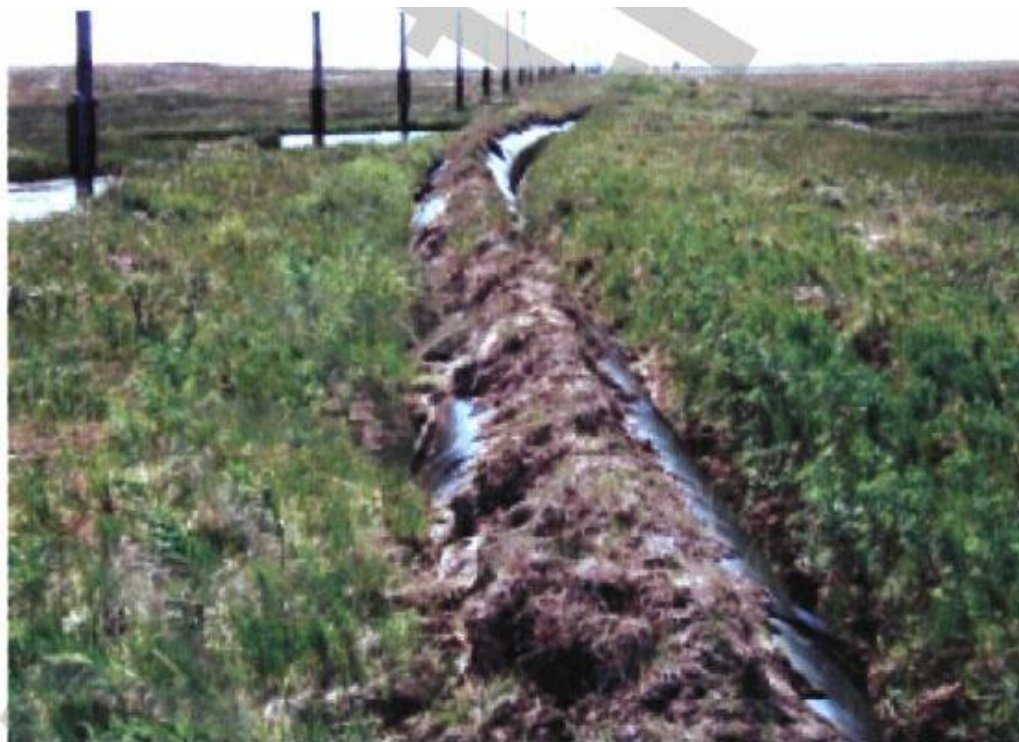
Рисунок 2 – Нарушение проектного положения газопровода, разрушение обваловки в результате развития процесса пучения
