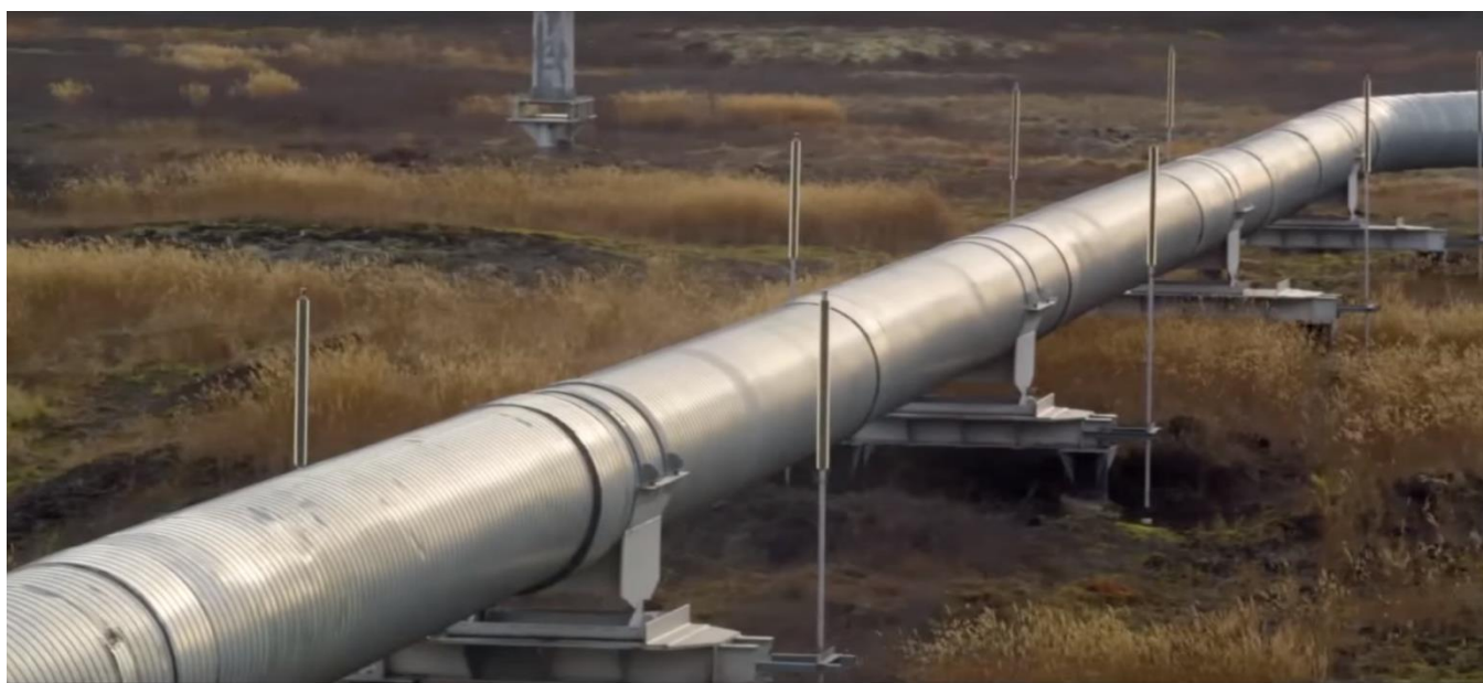
Рисунок 9 – Индивидуальные термостабилизаторы используемые при наземной прокладке газопровода
