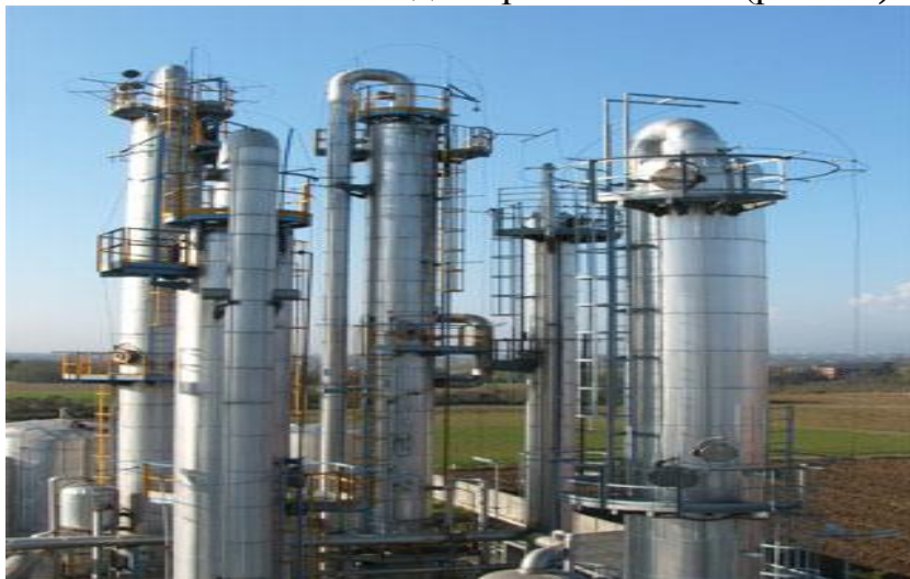
Рис. 1.1. Современные ректификационные колонны.
