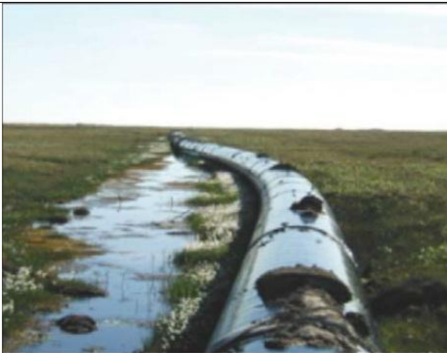
Рисунок 6 – Нарушение проектного положения газопровода вследствие развития процесса термокарста и всплытия трубы
