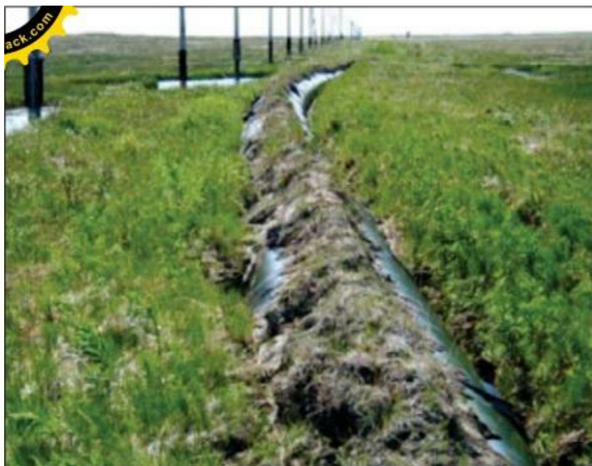
Рисунок 4 – Разрушение обваловки и нарушение проектного положения газопровода вследствие развития процесса пучения грунтов
