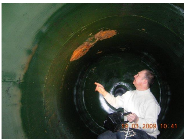
Рис. 1.5.5 Пример дефектного участка внутреннего покрытия эмалированного ёмкостного химического оборудования [115]
