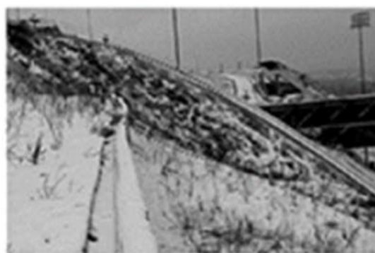
Рис. 1 Откосы склона, сложенные структурно-неустойчивыми грунтами.
