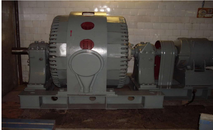
Рис. 3. Общий вид электропривода насоса
