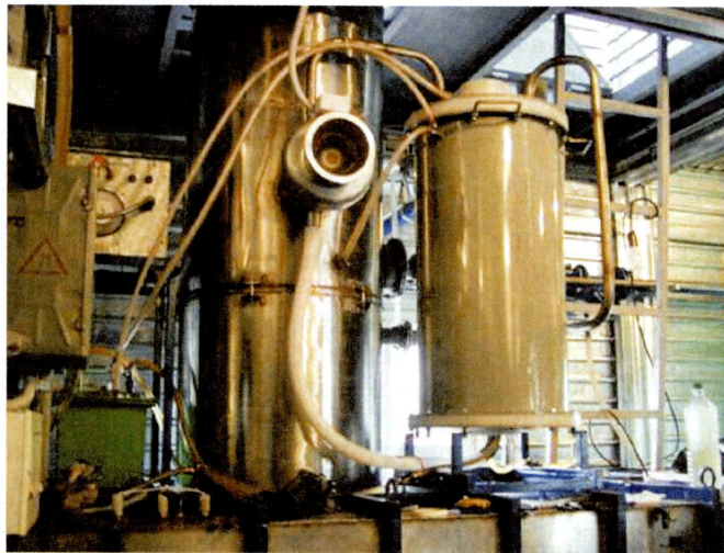
Водоочистной комплекс «Аэрозон».
