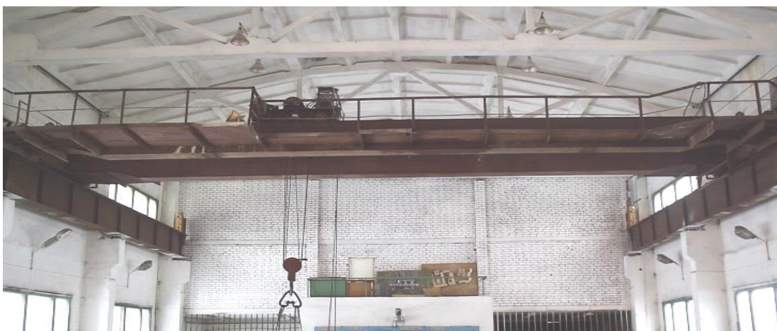
Рисунок 4.1– Внешний вид мостового крана МК-10
