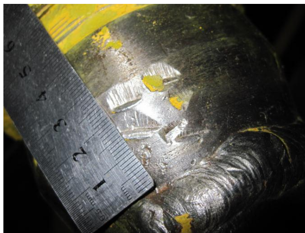
Рисунок 4.1.3 – Механическое повреждение (забоины) на поверхности элемента
