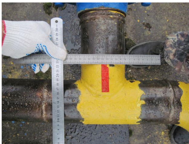
Рисунок 4.1.2 – Диаметр ответвлений от газопровода превышает 0,3 диаметра основной трубы
