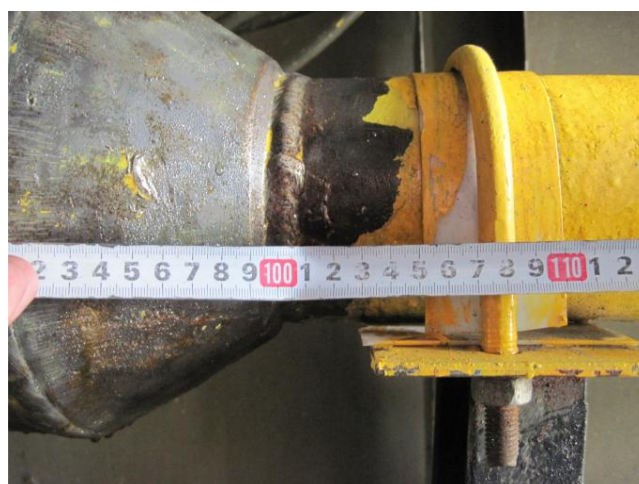
Рисунок 4.1.1 – Недостаточное расстояние от опоры до сварного соединения
