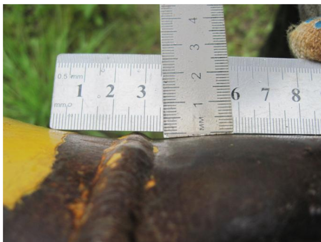
Рисунок 4.1.6 – Вмятины в околошовной зоне сварного соединения
