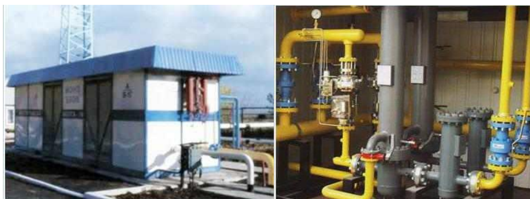
Рисунок 3.5.1 – Станция блочного типа «Ташкент-1»
