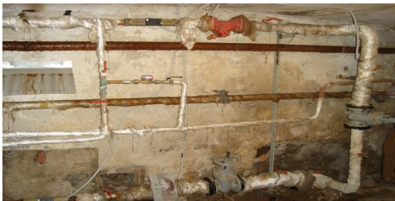
Рисунок 3.2.1 – Материальный износ инженерных сетей ТПУ
