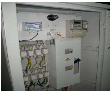
Рисунок 3.1.4 – Установленный прибор системы учета АСКУЭ
