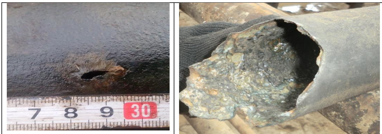
Рисунок 3.6 – Коррозия наружной поверхности НКТ на скважине G-2 (слева) и вид внутренней поверхности НКТ на скважине №114 (справа)
