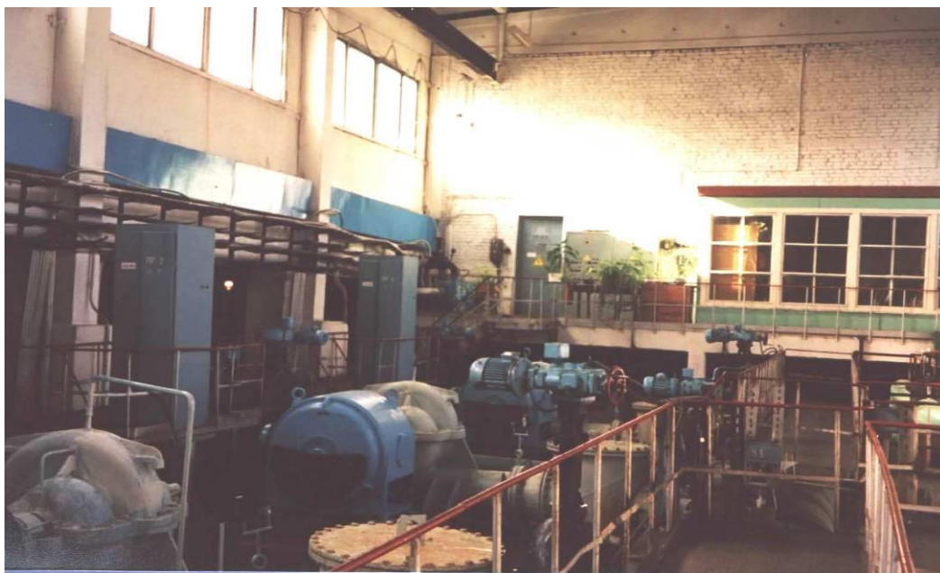
Рисунок 6 Насосная станция второго подъема
