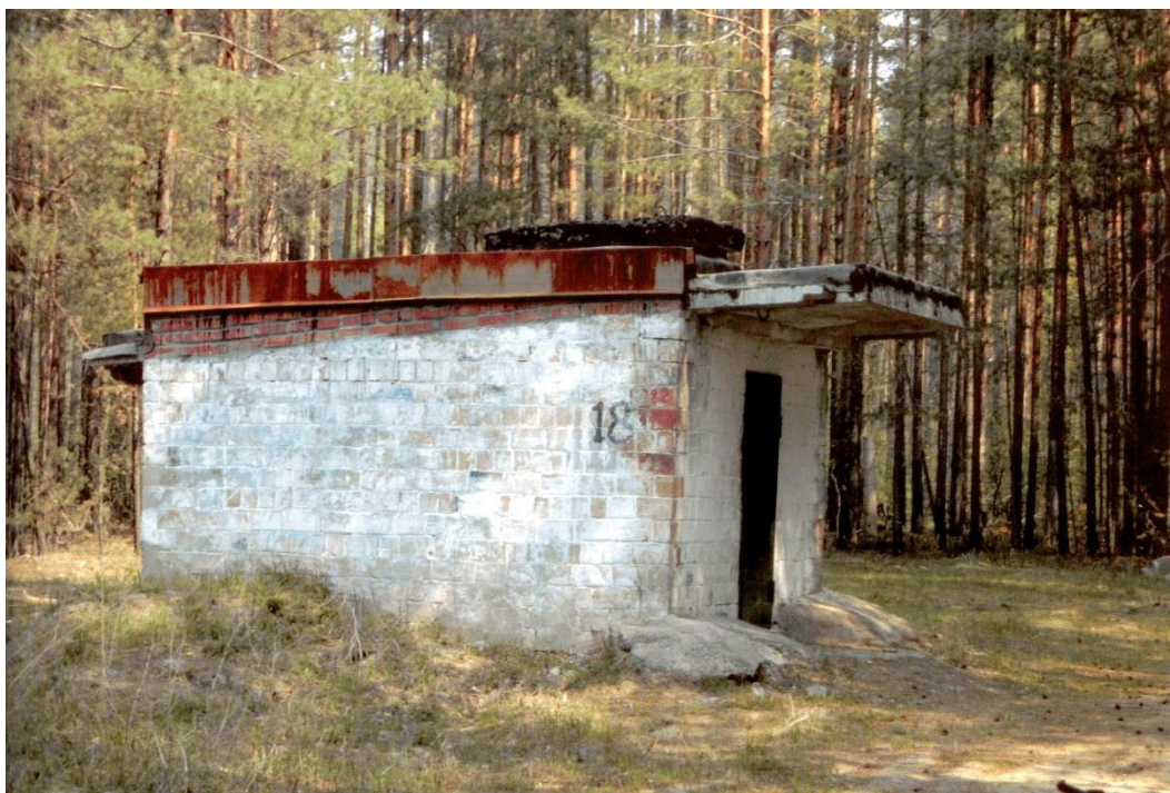
Рисунок 8. Павильон водозаборной скважины
