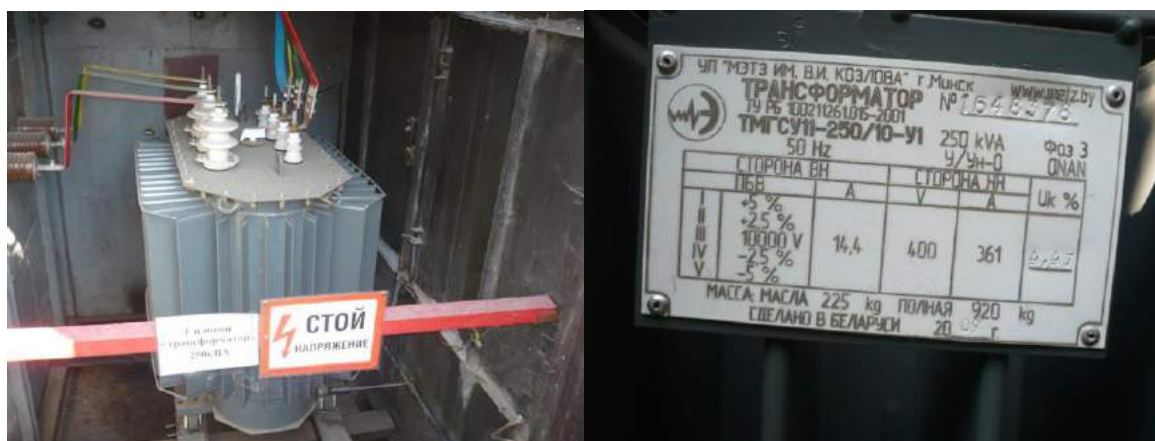
Рисунок 2.18 –Трансформатор типа ТМГСУ11
