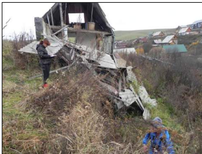
Рисунок 37 – Разрушенный оползнем дом по ул. Гагарина, 45 в г. Горно-Алтайске
