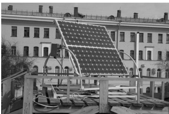
Рисунок 8 – Механическая часть энергетической установки АФЭУ-0,5 с двумя фотоэлектрическими панелями КСМ-160
