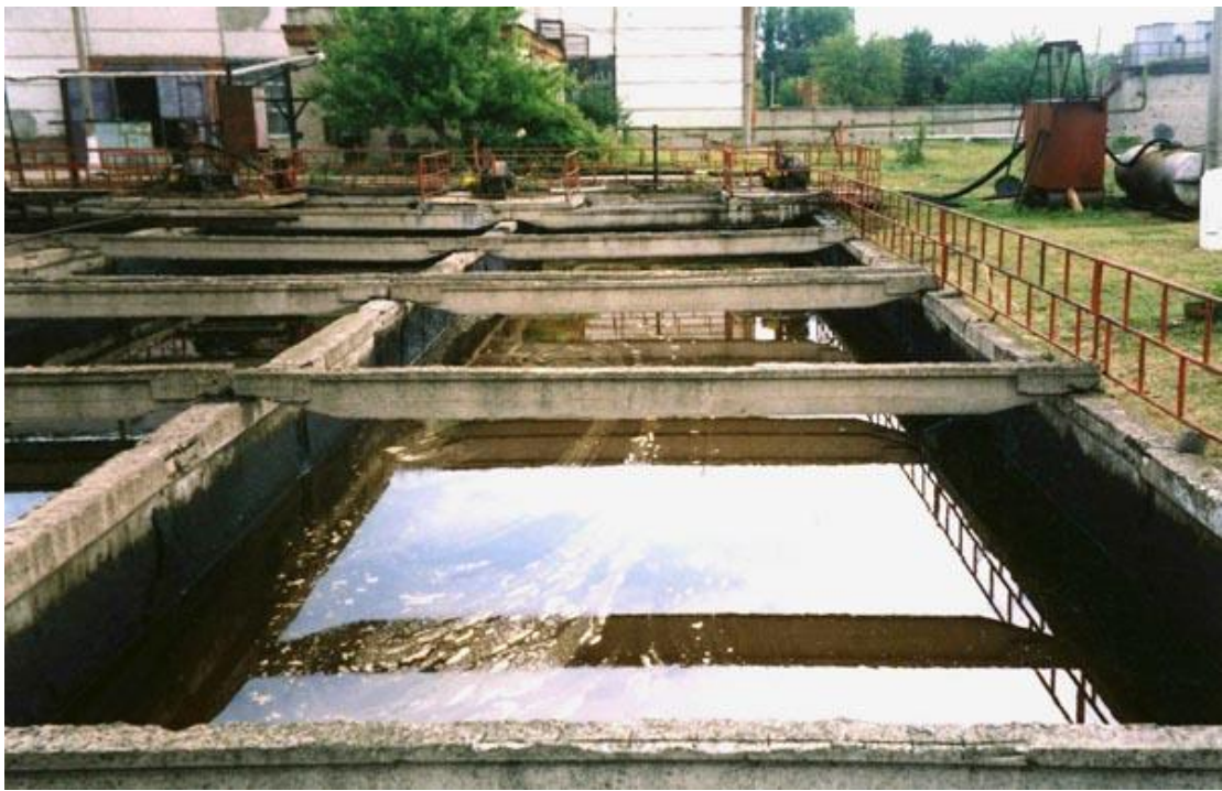
Рисунок 2.2 – Нефтеловушка, установленная на НПЗ
