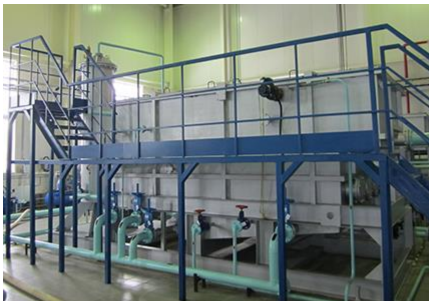
Рисунок 2.6 – Напорный флотатор в закрытом помещении[22]
