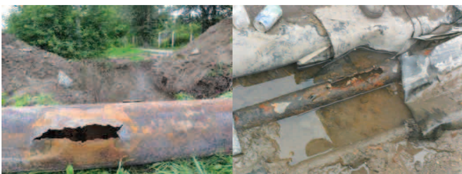
Рис. 10. Внешняя коррозия трубопроводов тепловых сетей
