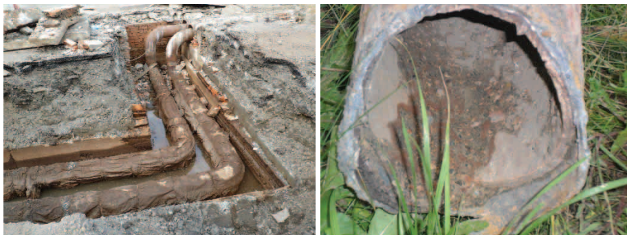
Рис. 9. Внутренняя коррозия трубопроводов тепловых сетей
