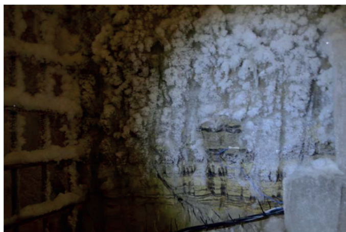
Рис. 4. Выветрелый борт горной выработки ЦВМ с установленным температурным датчиком
