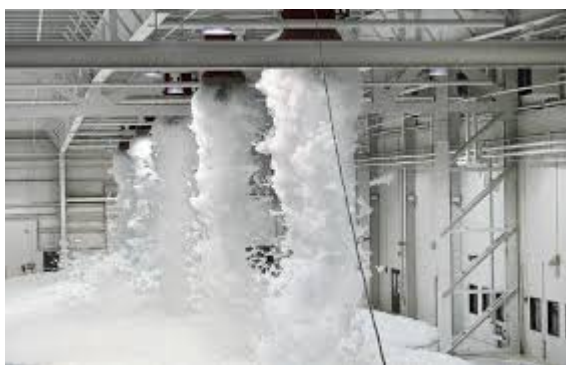
Рисунок 4 – Тестирование системы пенного пожаротушения
