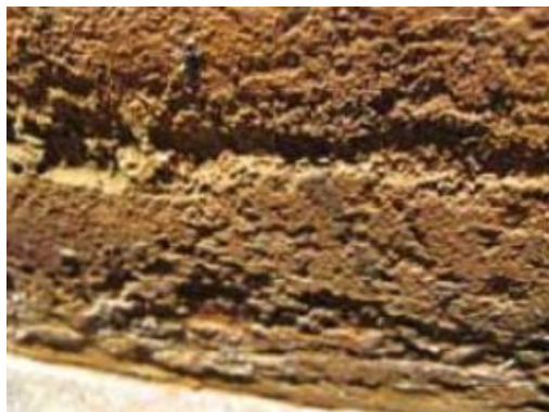
Рисунок 4 - Коррозионные дефекты, вызванные воздействием подтоварной воды
