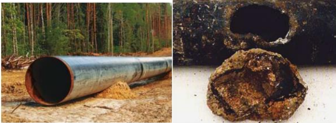
Abb. 1 Korrosionsschaden an Rohrleitung
