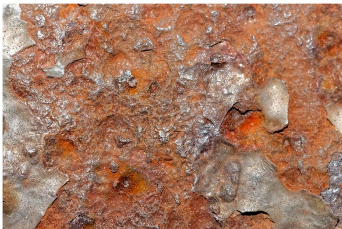
Рис. 7 Сплошная коррозия металла
