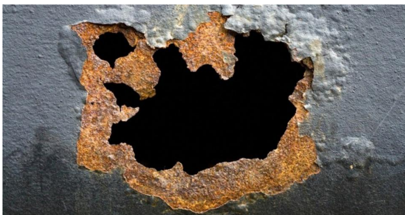
Рис. 8 сквозная коррозия металла
