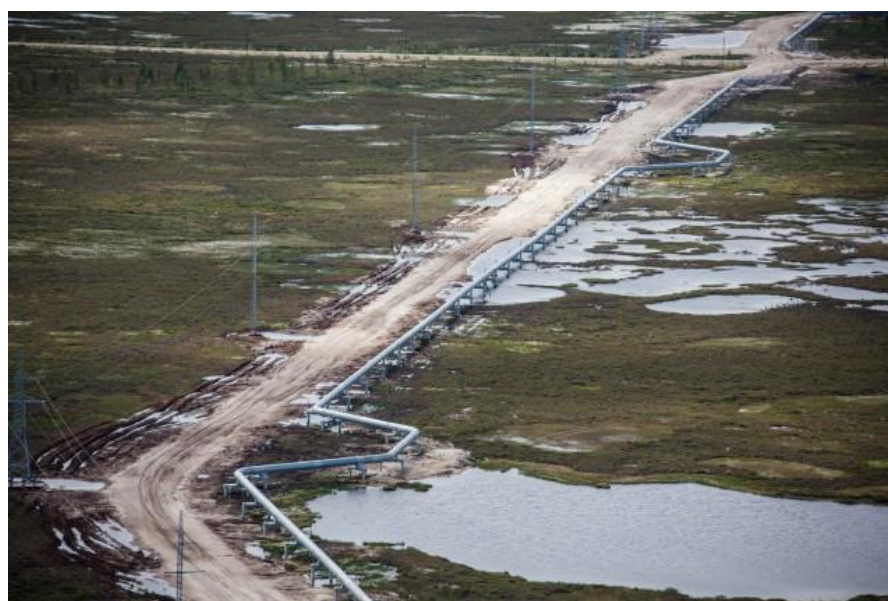
Рисунок 13 – Компенсаторы на трассе магистрального нефтепровода
