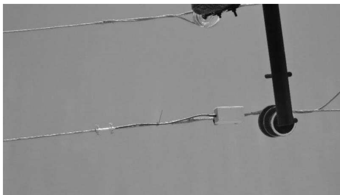
Рис. 3 Пилотная модель модуля измерения температуры провода на проводе ВЛ-10Кв
