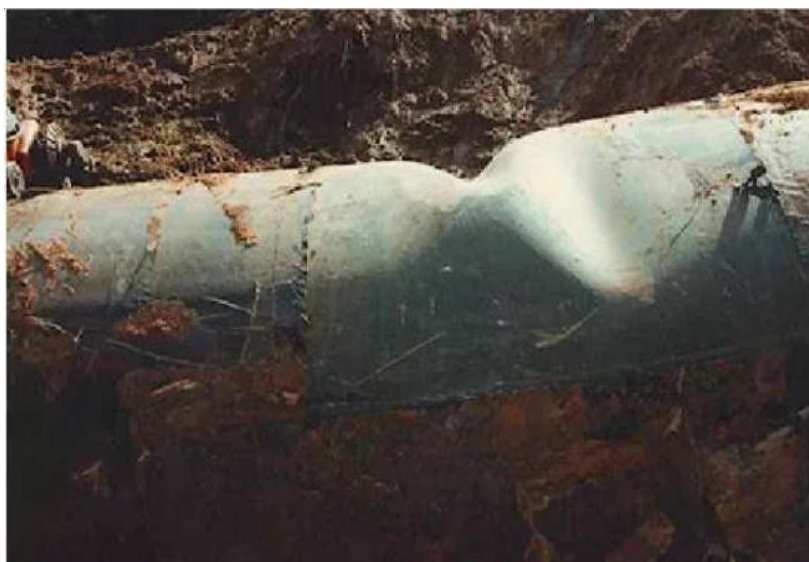
Рисунок 1 – дефект трубопровода в виде гофры.
