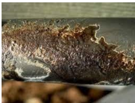
Рисунок 7 – Питтинговая коррозия алюминиевой трубы
