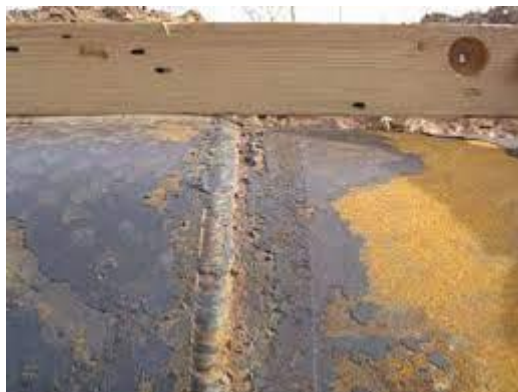
Рисунок 3— Общая коррозия на поверхности трубопровода на участке разрушенной изоляции
