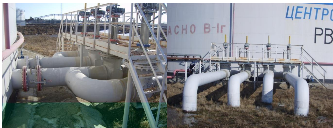
Рисунок 10 Приемо- раздаточные устройства с коренными задвижками
