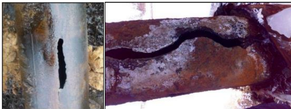
Рисунок 4 – Коррозия нефтесборного промышленного трубопровода
