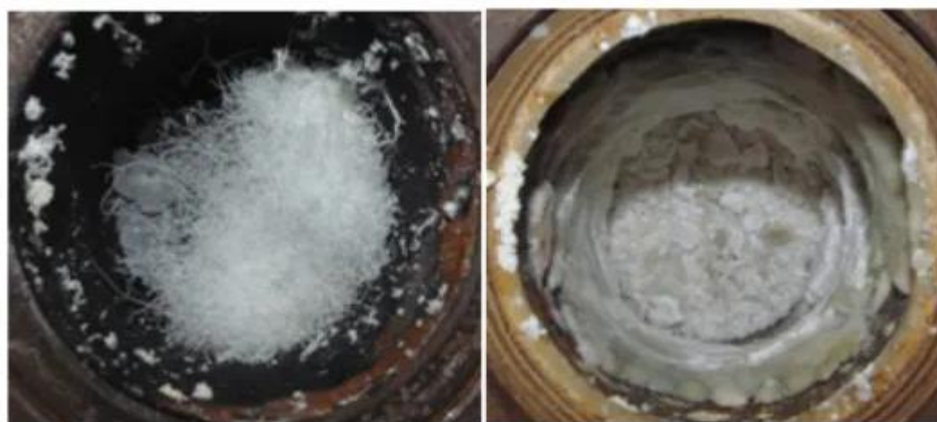
Рисунок 28 – Отложение гидратов на стенках насосно-компрессорных труб
