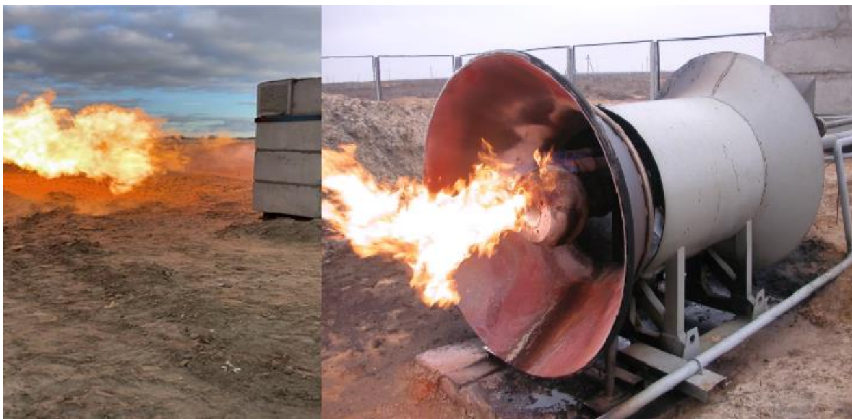
Рисунок 22 – Горизонтальная факельная установка
